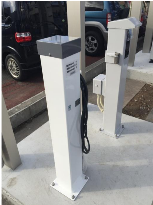
充電器の設置例（設置場所：福岡県 直方市駐車場）
