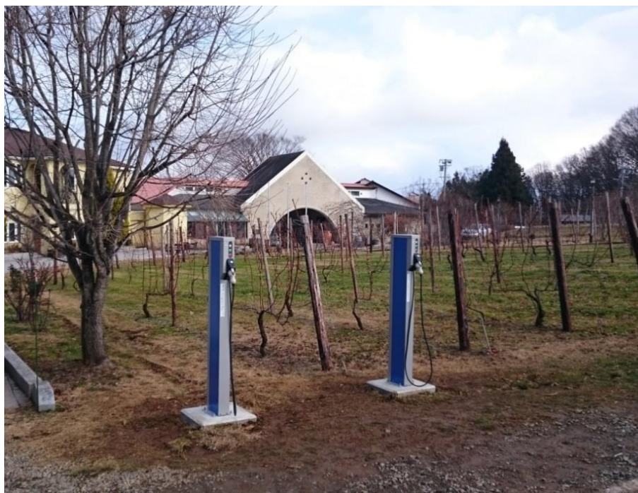
充電器の設置例（設置場所：長野県 サンクゼールワイナリー）
