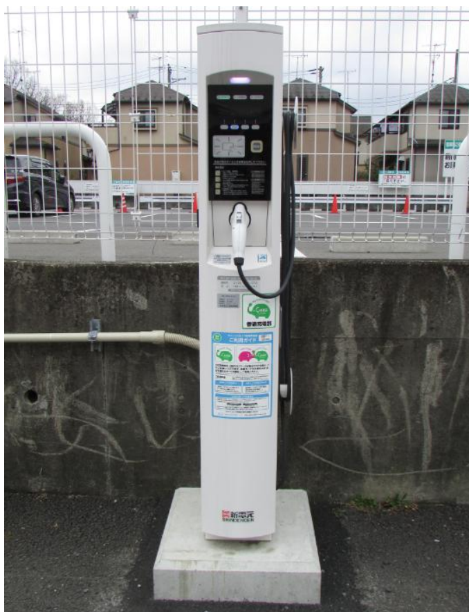
充電器の設置例（設置場所：埼玉県 ニトリ新座店）
